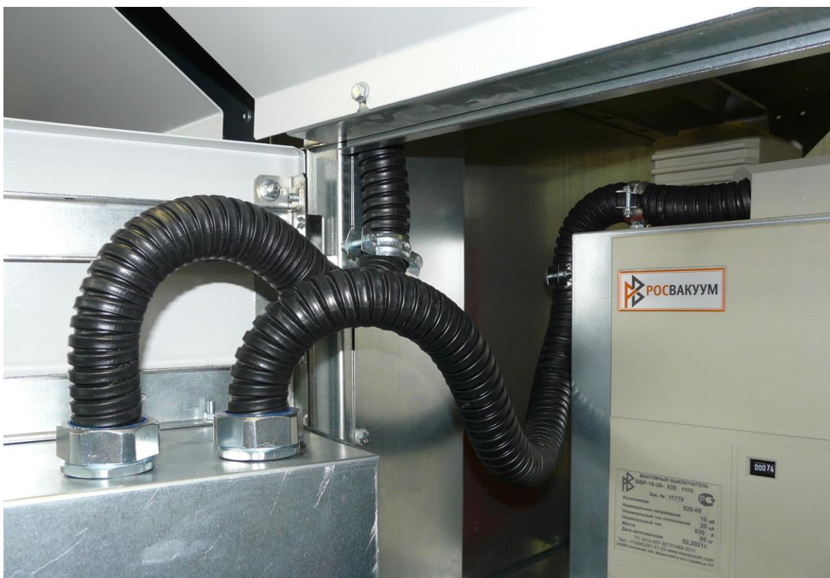
Рис. 11. Металлорукав для прокладки жгутов проводников вторичных цепей
