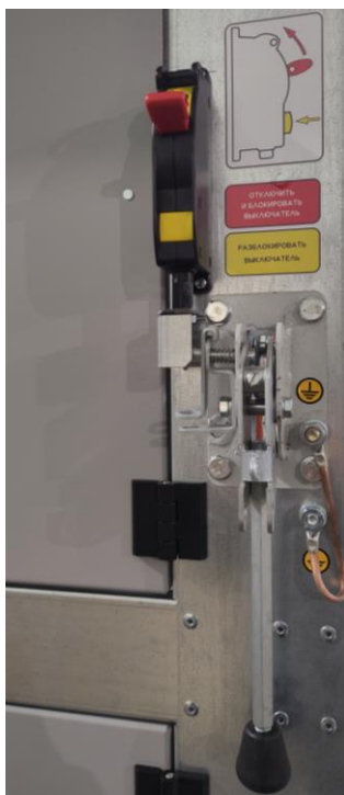
Рис. 6.3. Механическая блокировка привода ПР-10 от выключателя
